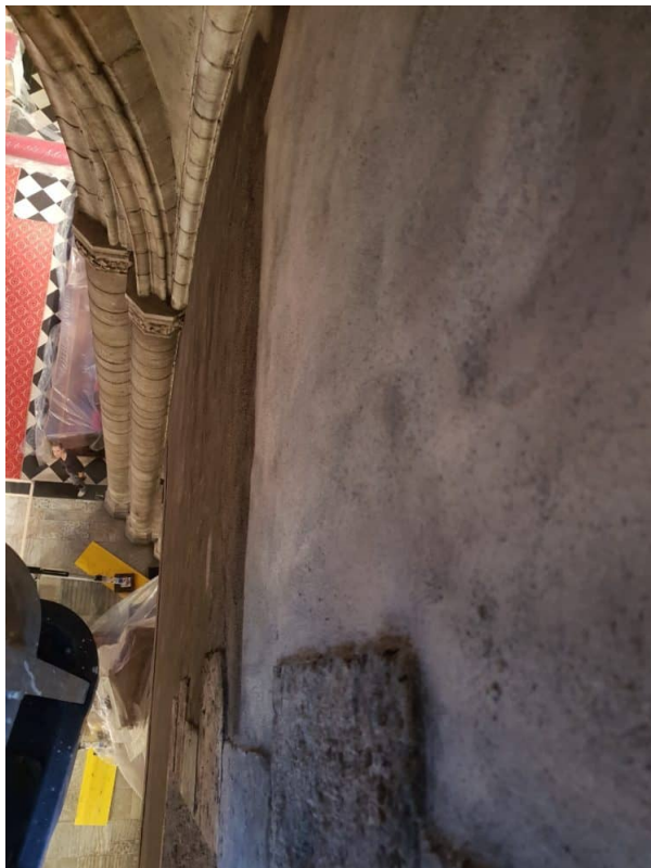
Extreme Verschmutzung der Aussenwände.
